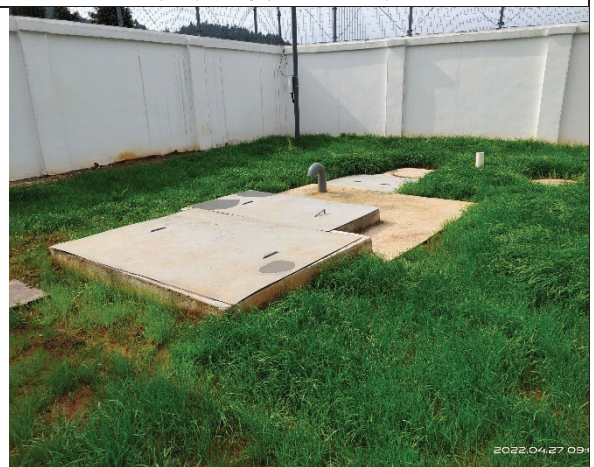
永顺分输站污水处理设施处 绿化
