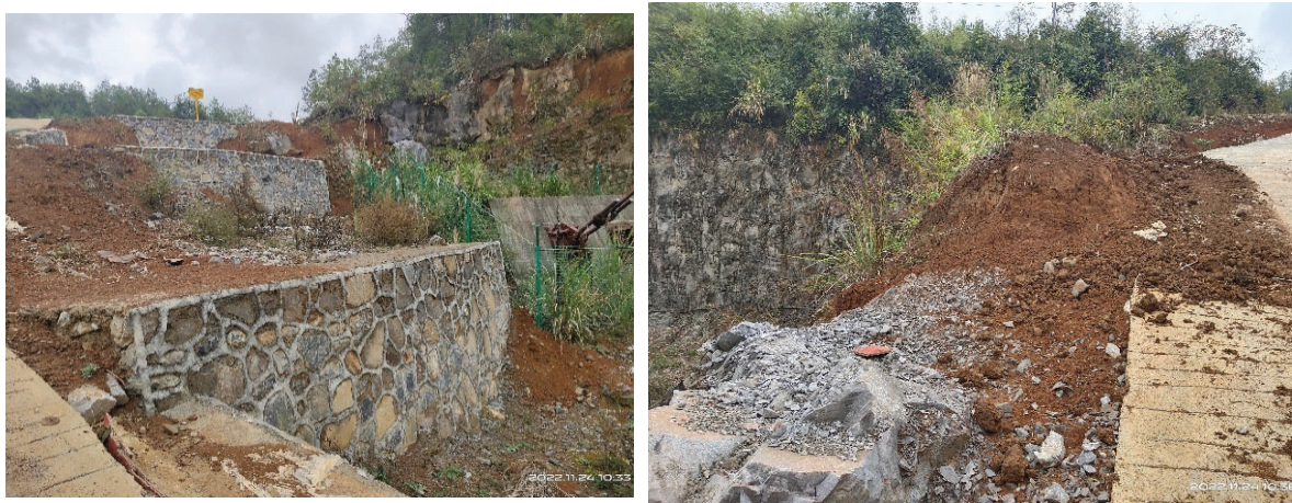
图 5.3-1 生态恢复不完善管段现状照片
