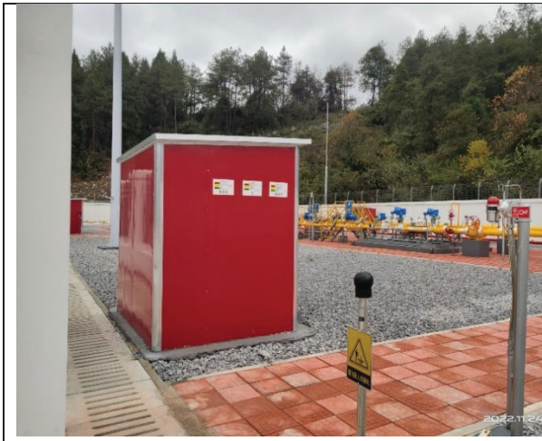
永顺分输站工艺区
